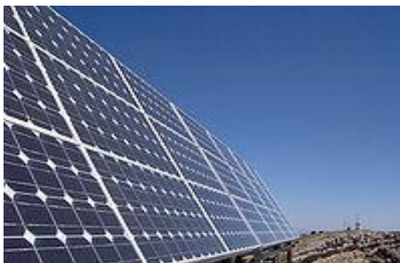
Figura 1.3. Paneles solares fotovoltaicos.
