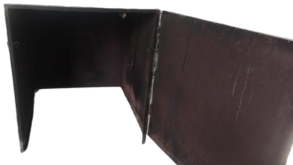
Figura. 1 Daño estructural de la cámara del horno
