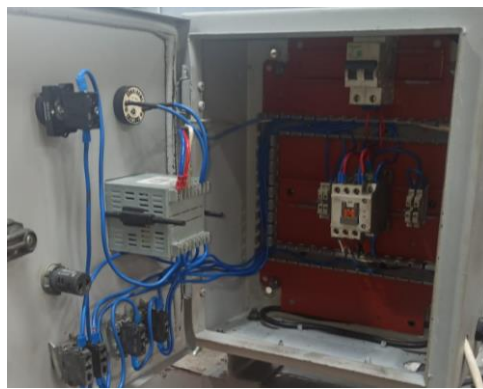
Figura. 7 Conexiones tablero de control
