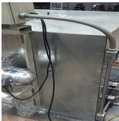
Figura. 11 Protección al cableado de los actuadores y el tablero de control
