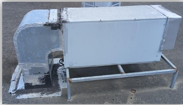
Figura 3. Unidad evaporadora y de Ventilación
