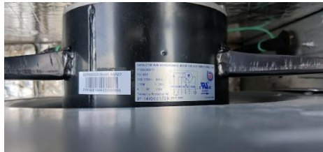
Figura 12. Ventilador de Aire Acondicionado
