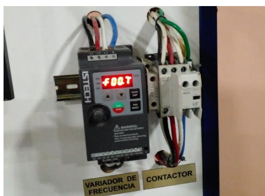
Figura 85. Encendido del variador de frecuencia
