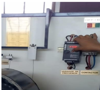
Figura 568. Encendido de la bomba eléctrica
