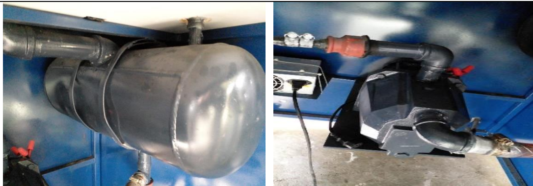
Figura 80. Tanque reservorio y bomba eléctrica
