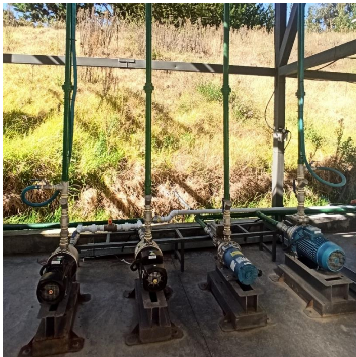
Figura 19. Bombas hidráulicas para la planta de tratamiento de agua.
