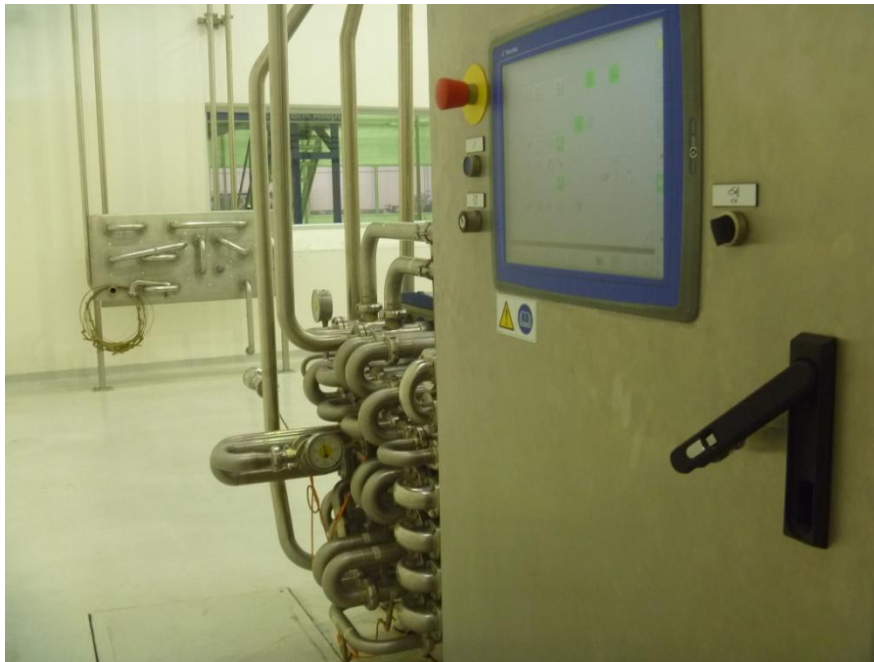
FOTOGRAFÍA N° 1. ESTERILIZADOR TETRA THERM® ASEPTIC FLEX - TETRA PACK. (DESDE LA IZQUIERDA: THE, HMI-PLC). EL ORDEÑO S.A.
