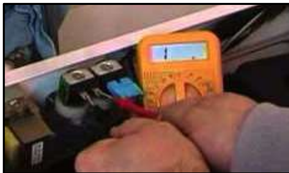
Figura 5.16. Comprobación de continuidad en la bobina de la electroválvula.
