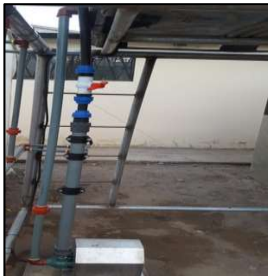
Figura 5.8. Tubería de 1" para la succión de la bomba
