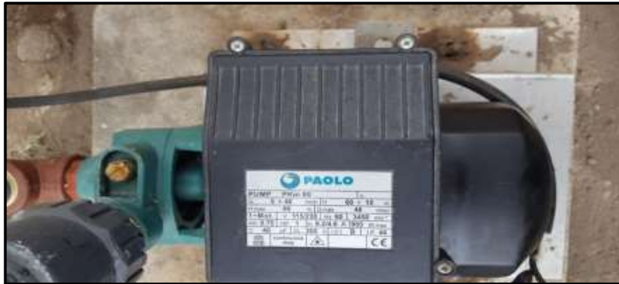
Figura 5.7. Bomba de agua.
