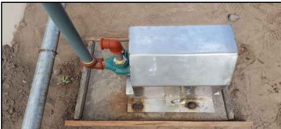
Figura IV.1. Armadura para la protección de la bomba 1Hp
