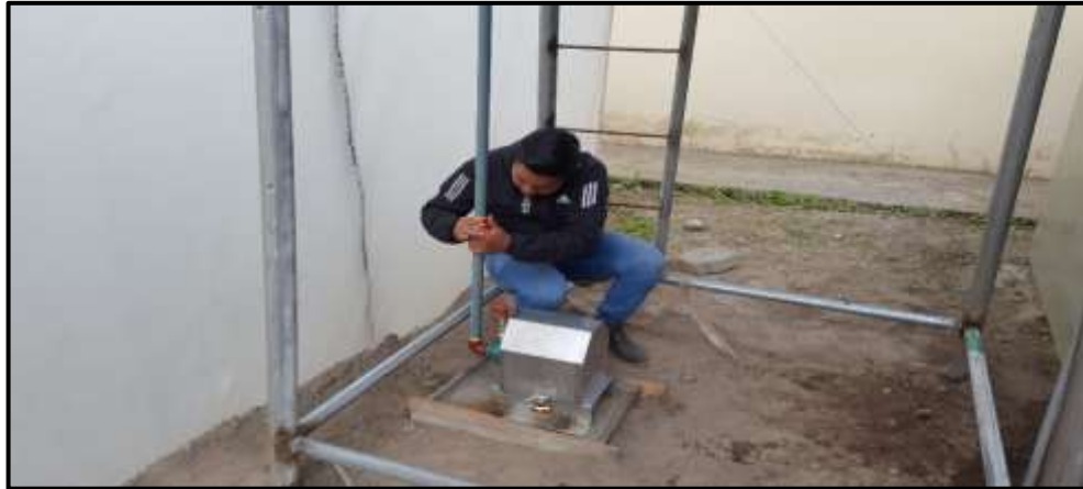
Figura IV.2. Instalación para la parte de succión de la bomba 1Hp
