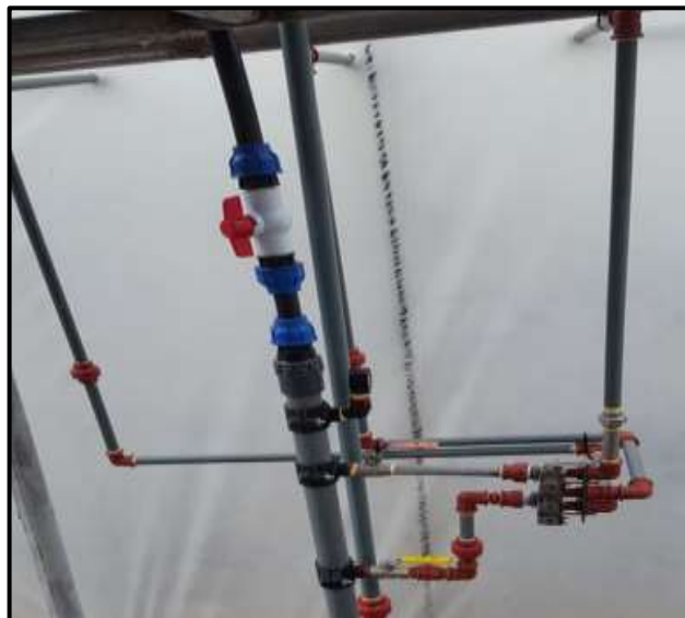
Figura 5.10. Sistema de tubería para la nebulización del invernadero
