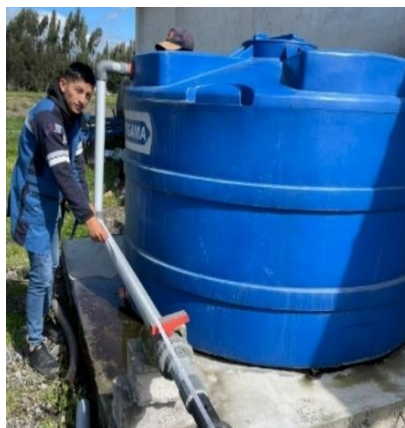
Figura 4-6 Tanque de almacenamiento Primario
