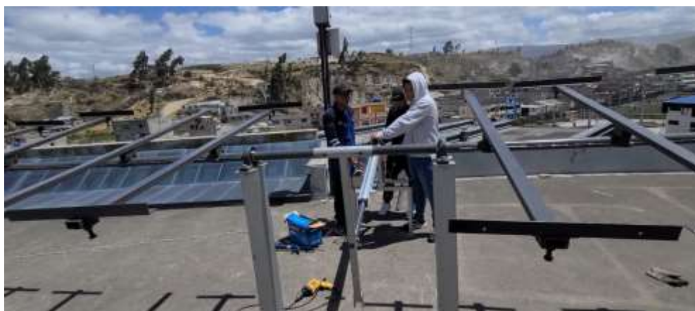
Figura 5.41. Prueba de funcionamiento sin paneles.
