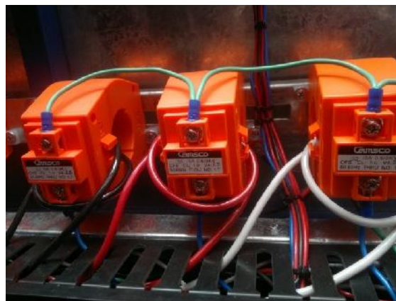
Figura 1.52 Transformadores de corriente
