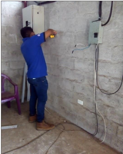
Fotografía 25. Ubicación de los tableros de mando.
