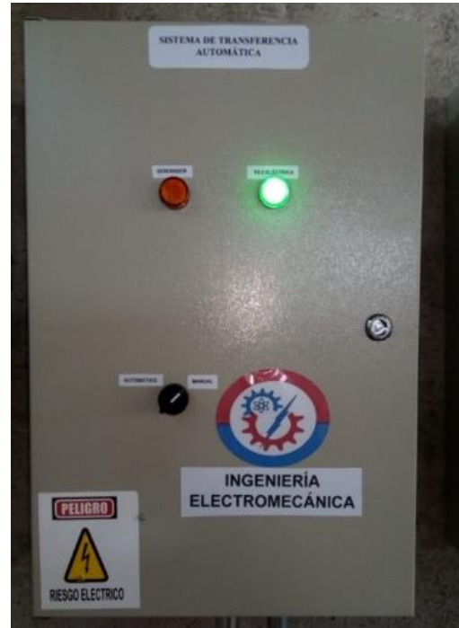
Fotografía 38. Tablero de transferencia automática.
