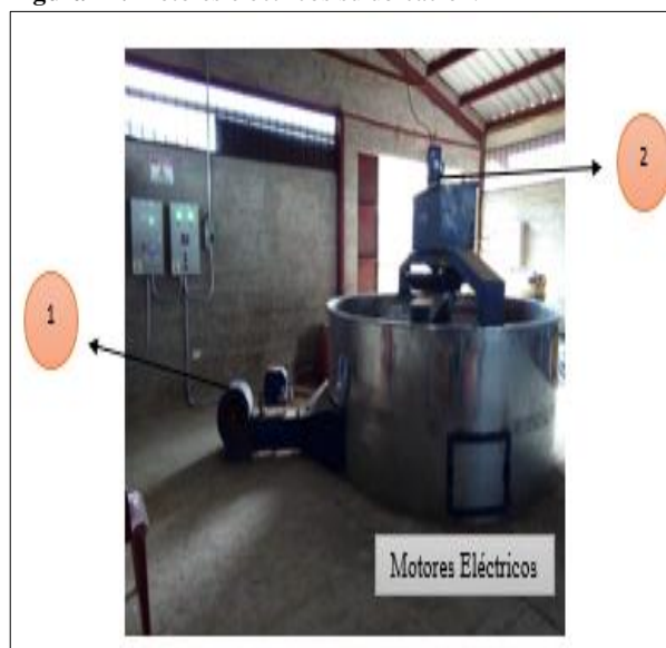
Figura 24. Motores eléctricos su ubicación.
