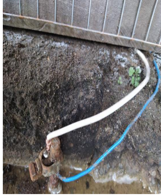
Fotografía 43. Puesta a tierra.
