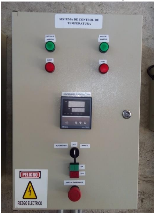
Fotografía 39. Tablero de control de temperatura.
