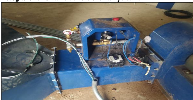
Fotografía 19: Sistema de control de temperatura.
