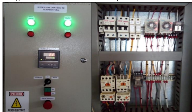
Fotografía 17: Sistema de control de temperatura.
