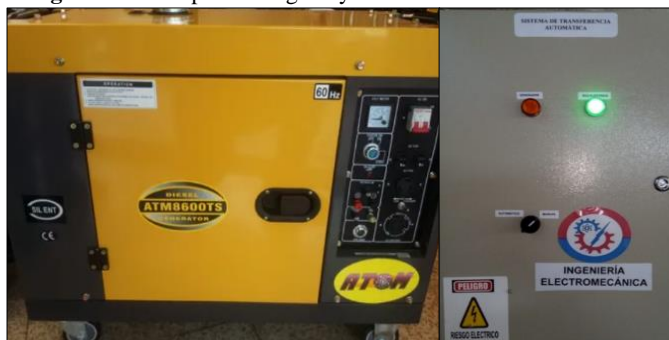
Fotografía 18. Grupo electrógeno y tablero de transferencia.
