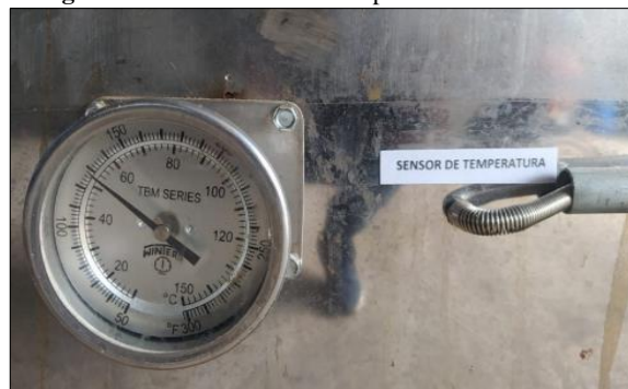
Fotografía 21: Actuadores de temperatura.
