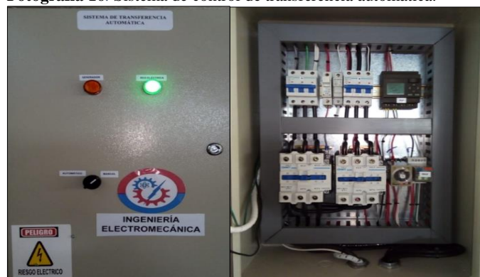
Fotografía 16. Sistema de control de transferencia automática.
