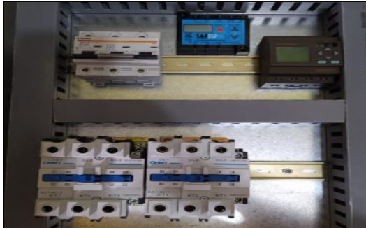
Fotografía 13. Contacto en el tablero de transferencia automática.
