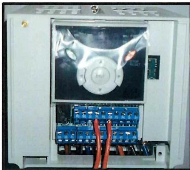
FIGURA 3.9: VARIADOR DE FRECUENCIA
