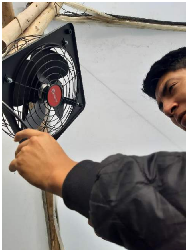
Figura C.4. Proceso de energización del extractor de aire montero
