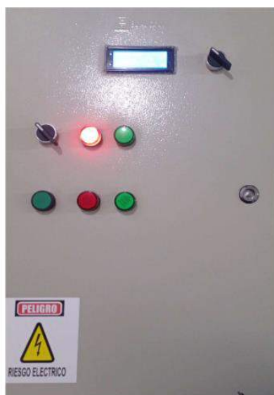
Figura 5.27. Tablero de control del Invernadero
