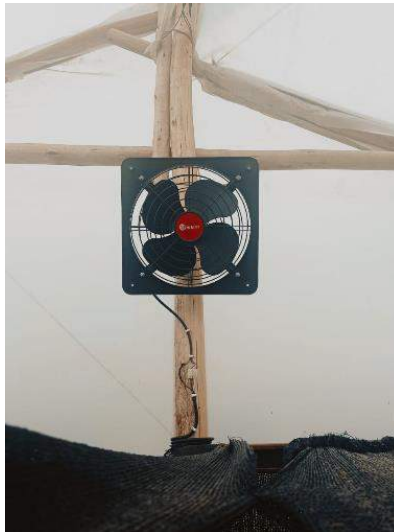
Figura 5.8. Ubicación del extractor de aire para el correcto funcionamiento
