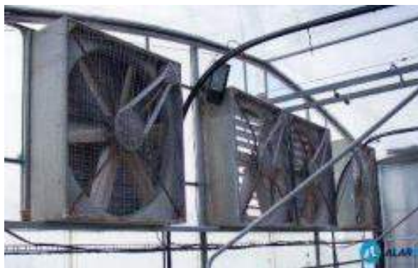
Figura 3.6. Ventilación Activa de los Invernaderos [6]
