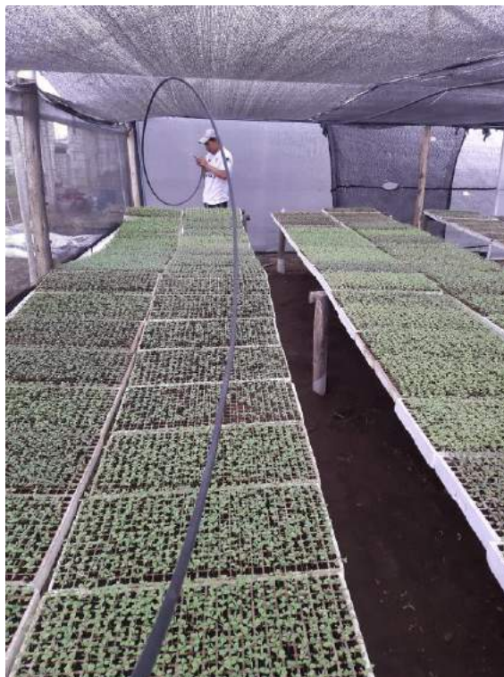
Figura B.6. Instalación de las líneas secundarias del sistema de regadío de agua
