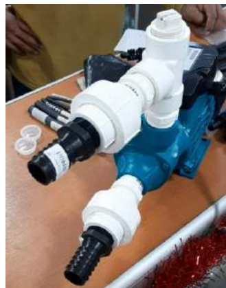
Figura 4.12. Implementación de accesorios para bomba centrífuga
