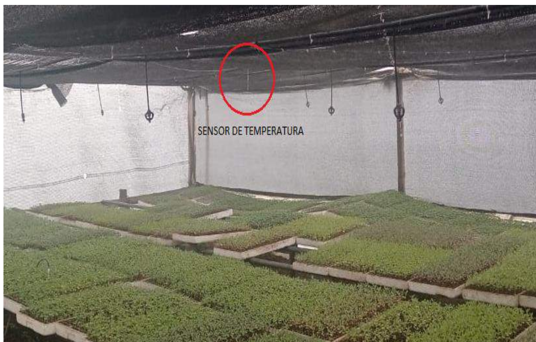
Figura C.2. Instalación del sensor de temperatura Termocupla tipo K
