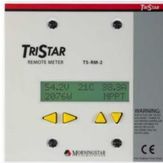
Figura 34. Pantalla de monitoreo de datos instalada en el sistema fotovoltaico.
