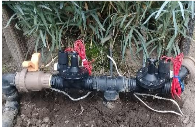
Figura 29. Ubicación de las electroválvulas
