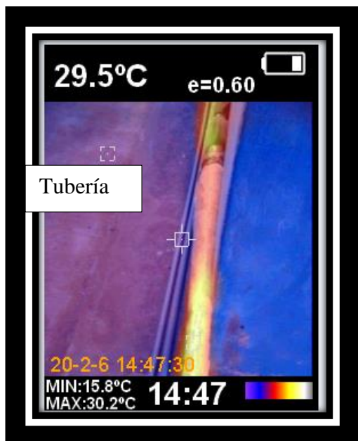
Figura IV-1 Imagen térmica de la tubería Fuente: [1]
