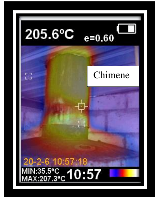
Figura III-3 Imagen térmica de la chimenea Fuente: [1]
