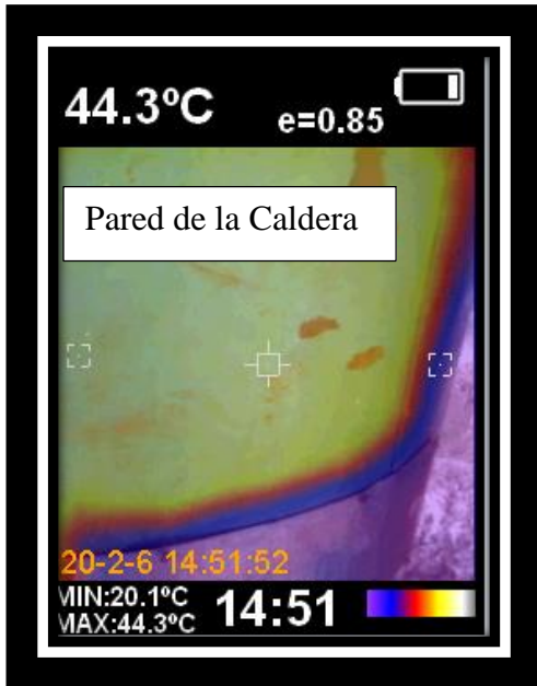
Figura III-1 Imagen térmica de la pared de la caldera Fuente: [1]
