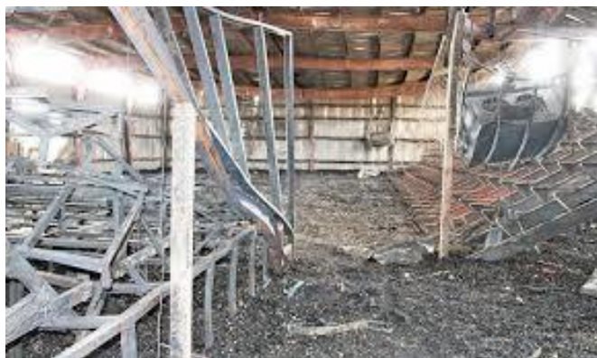
Fotografía 6.- Deformación de estructuras metálicas
