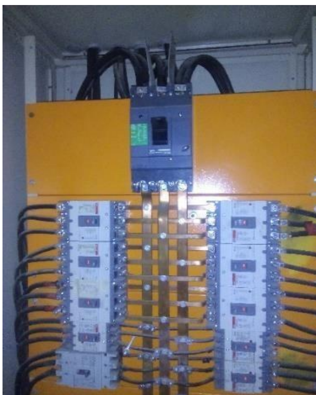
Figura 48. tablero principal Bloque B.
