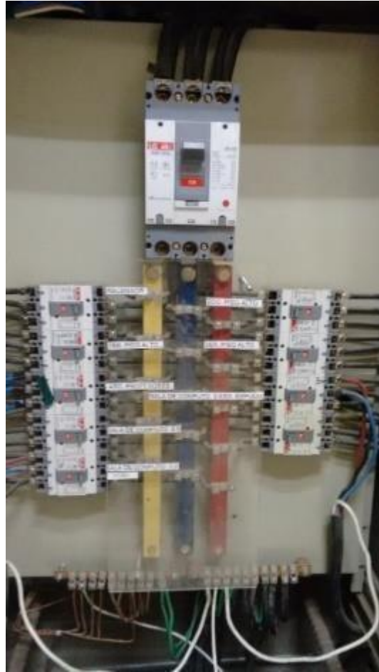
Figura 7. Tablero principal del bloque B.
