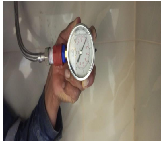
Figura 22. Medición de presión marcando 45 PSI.
