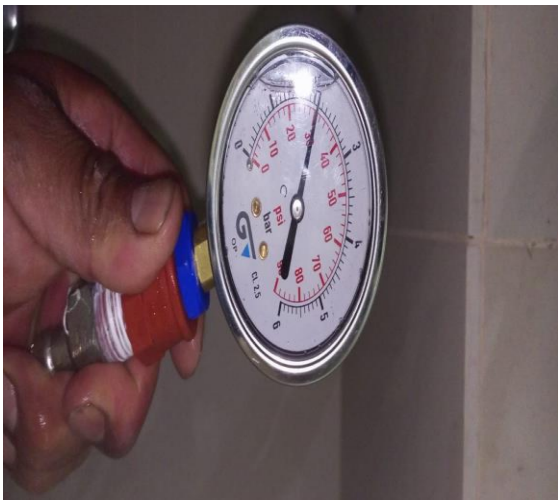
Figura 21. Medición de presión marcando 30 PSI.
