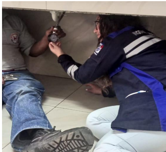
Figura 18. Comprobación de la presión de agua potable en el baño de hombres del Bloque B, con un valor registrado de 35 PSI.
