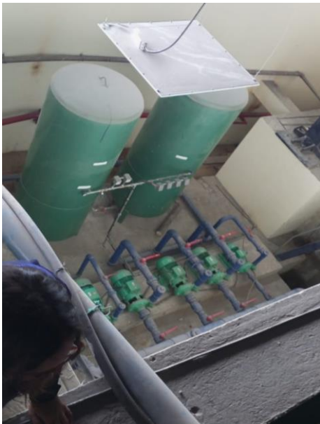
Figura 30. Verificación de bombas de agua potable.
