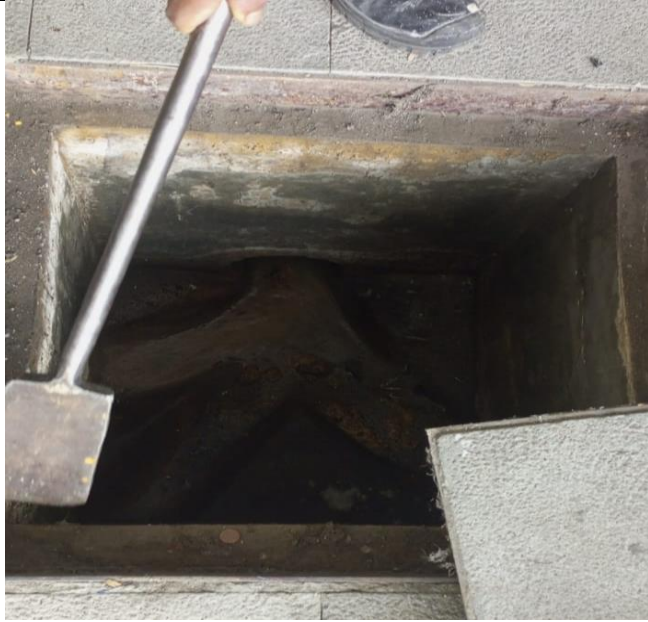
Figura 27. Levantamiento de información de redes sanitaria, se observa caja de revisión de alcantarillado salida del edificio B.
