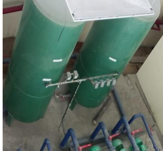
Figura 29. Verificación de tanque hidroneumático de agua potable.
