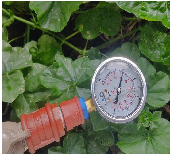
Figura 20. Medición de presión marcando 35 PSI.
