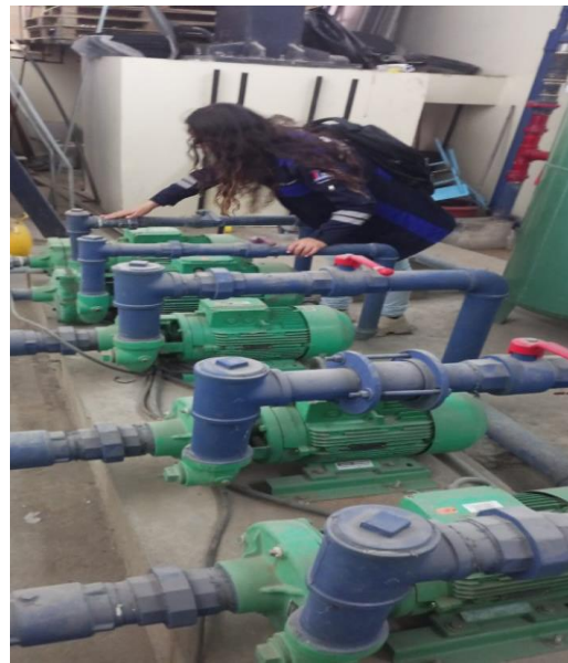
Figura 31. Verificación de bombas de agua potable.
