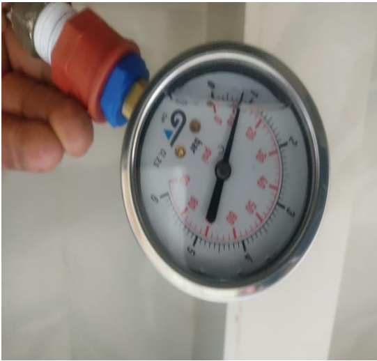
Figura 19. Medición de presión marcando 10 PSI.
