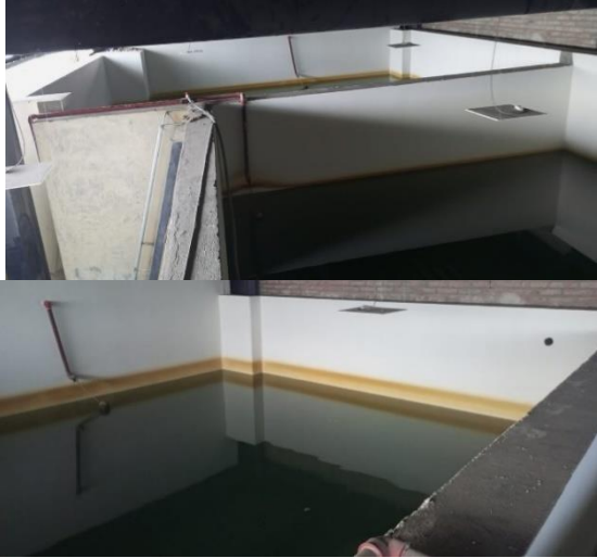
Figura 28. Verificación de cisternas de agua potable.
