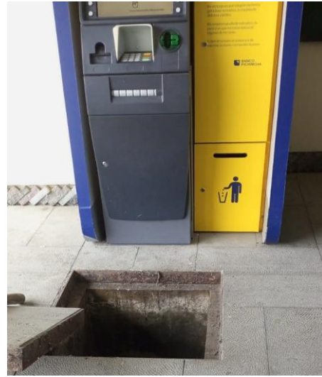
Figura 24. Verificación de la caja de revisión del Bloque B y del sentido del flujo de aguas residuales.
