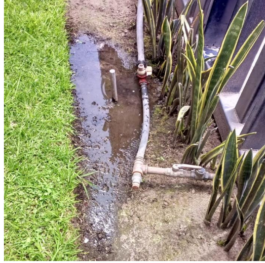
Figura 16. Se detectaron fugas de agua en el jardín frontal de la universidad debido al deterioro de los accesorios.
