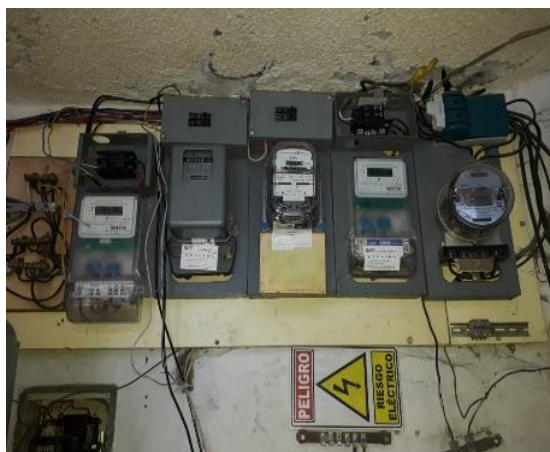
Figura 4.23 contadores de energía.
