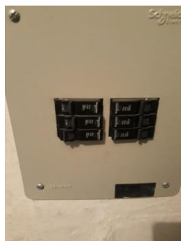
Figura 4.25 Tablero de distribución.
