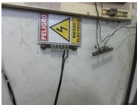
Figura 4.24 Puesta a tierra defectuosa.
