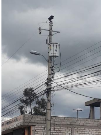
Figura 4.22 Transformador de 50 KVA.
