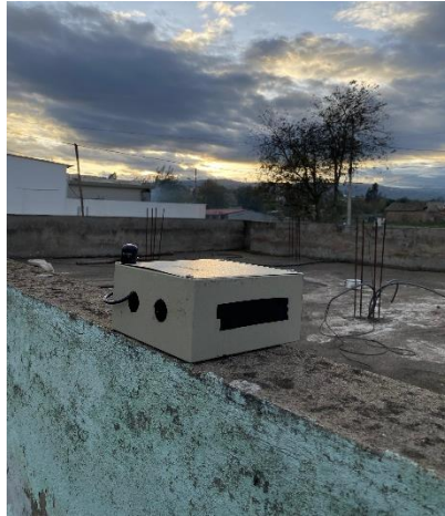
Figura 24. Piranómetro colocado en el barrio San Juan.
