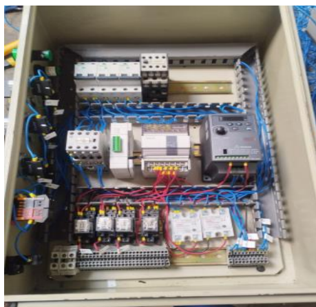
Figura 4.36. Conexión de cada elemento del tablero designado para la automatización.
