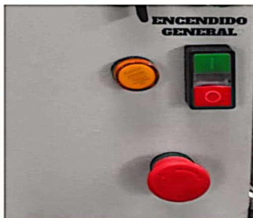
Figura 4. Panel de inicio principal y paro de emergencia.
