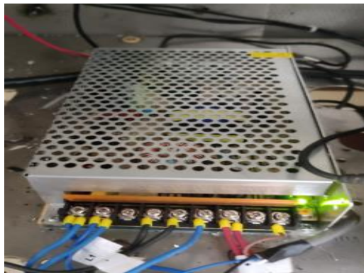
Figura 4.26. Fuente de alimentación 24V DC.
