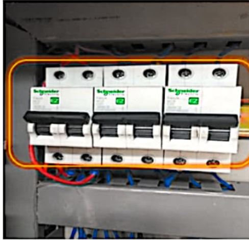
Figura 3. Activación de las protecciones eléctricas.
