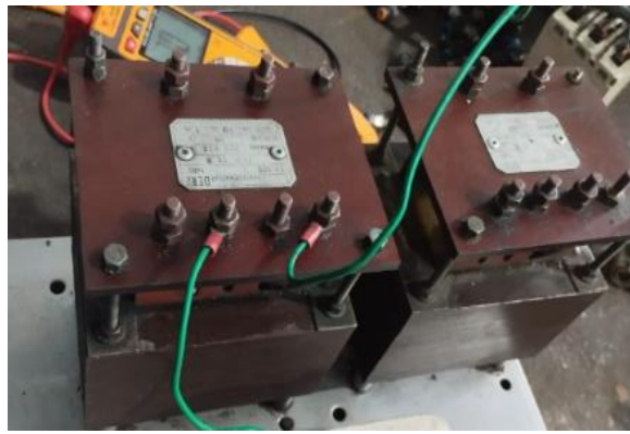
Figura 4.30. Transformador de núcleo laminado.
