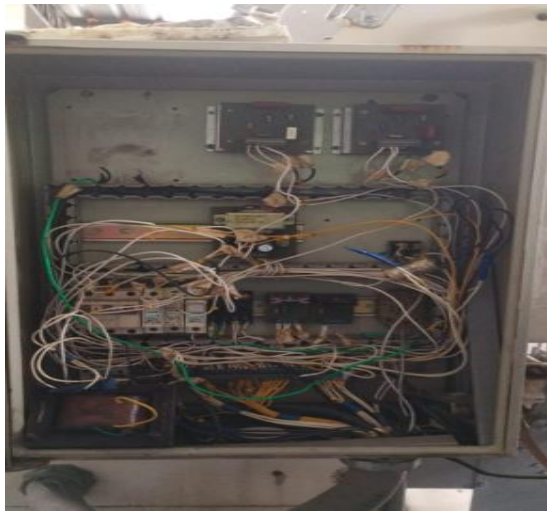
Figura 4.17. Sistema eléctrico de la máquina PREPAC sin automatizar.
