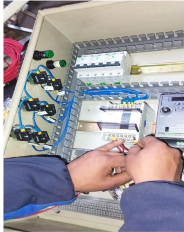
Figura 4.35. Cableado de los elementos eléctricos para la automatización de la máquina PREPAC.
