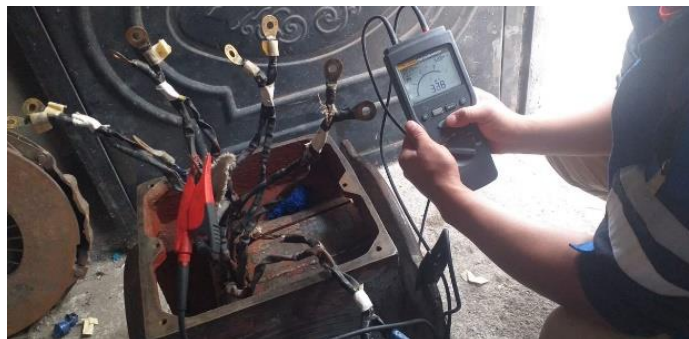
Figura IX.9 Medición de las aislamiento de los bobinados
