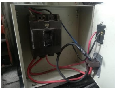
Figura 5.18 Protección de corriente nominal.
