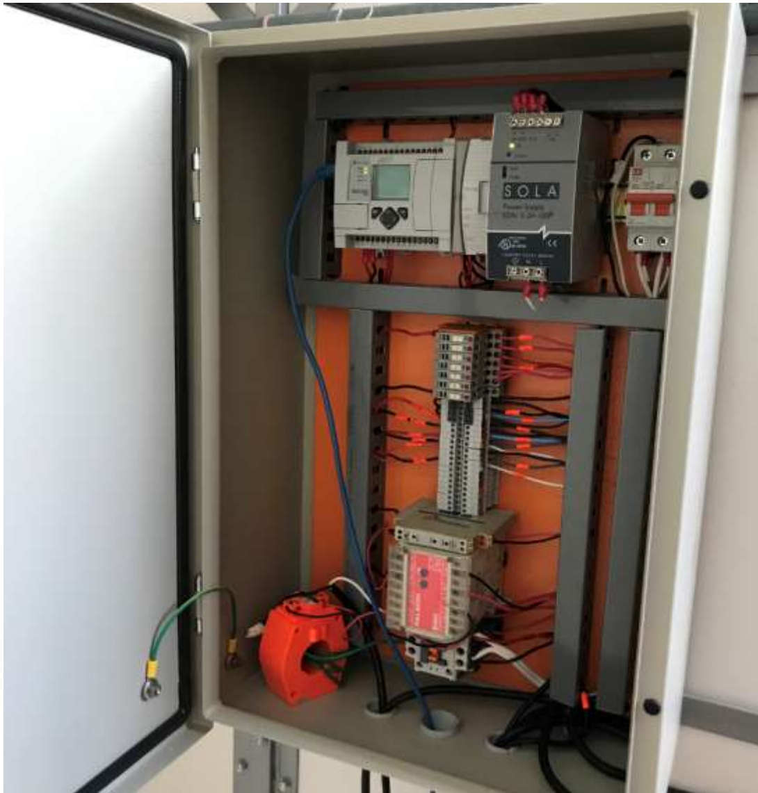
Figura 28. Caja de conexiones eléctricas y de control (Fuente: Luis Masapanta, autor)
