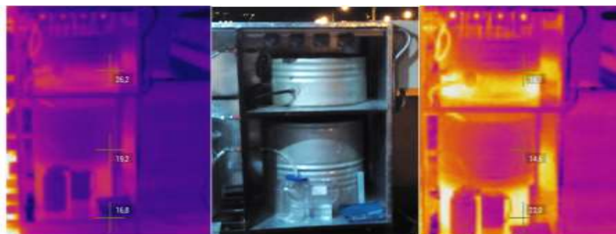
Gráfica 5.1 Torre de enfriamiento - Disipación de calor.
