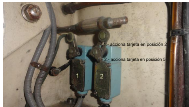
Fig. N° 26: SWITCH FINAL DE CARRERA ACCIONA TARJETAS EN POSICIÓN 2 Y 5:
