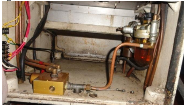
Fig. N° 56: Tuberías de Aire de Electroválvula
