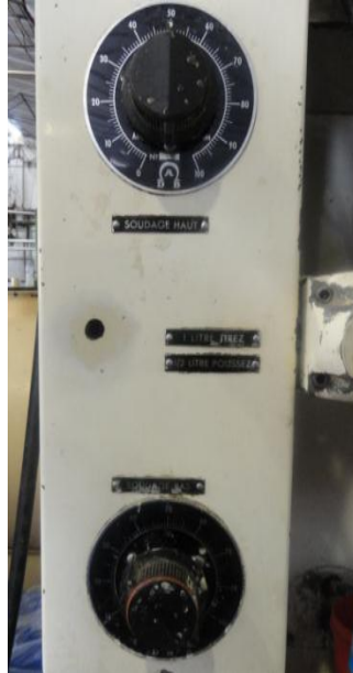
Fig. N° 29: POTENCIÓMETROS QUE REGULAN LA CANTIDAD DE CORRIENTE A LAS RESISTENCIAS ELÉCTRICAS
