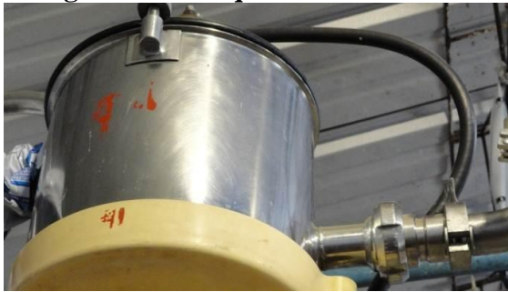
Fig. N° 55: Tanque de Alimentación
