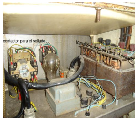
Fig. N° 28: CONTACTOR Y TRANSFORMADORES DE SELLADO
