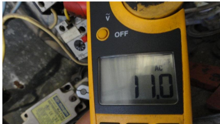
Fig. N° 51: MEDICIÓN DE LA CORRIENTE DE CONSUMO EN LA ENVASADORA ANTES DE LA AUTOMATIZACIÓN CON EL PLC
