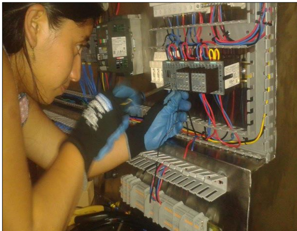
Conexiones de los equipos de protección
