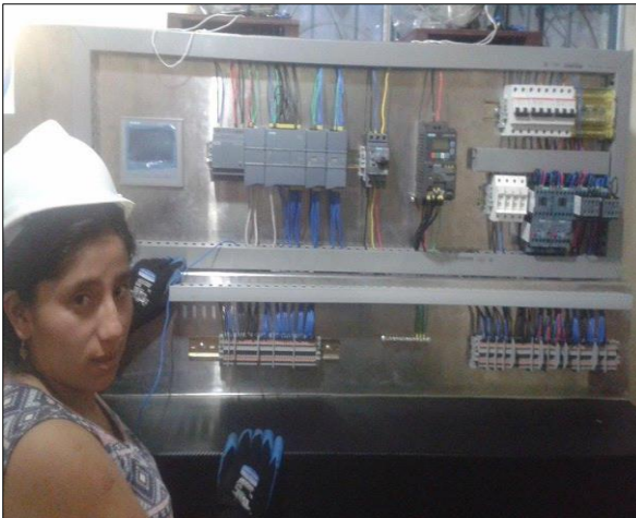
Cableado de PLC S7-1200
