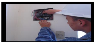
Fuente: Mantenimiento eléctrico 2015 Elaborado por: El maestrante
