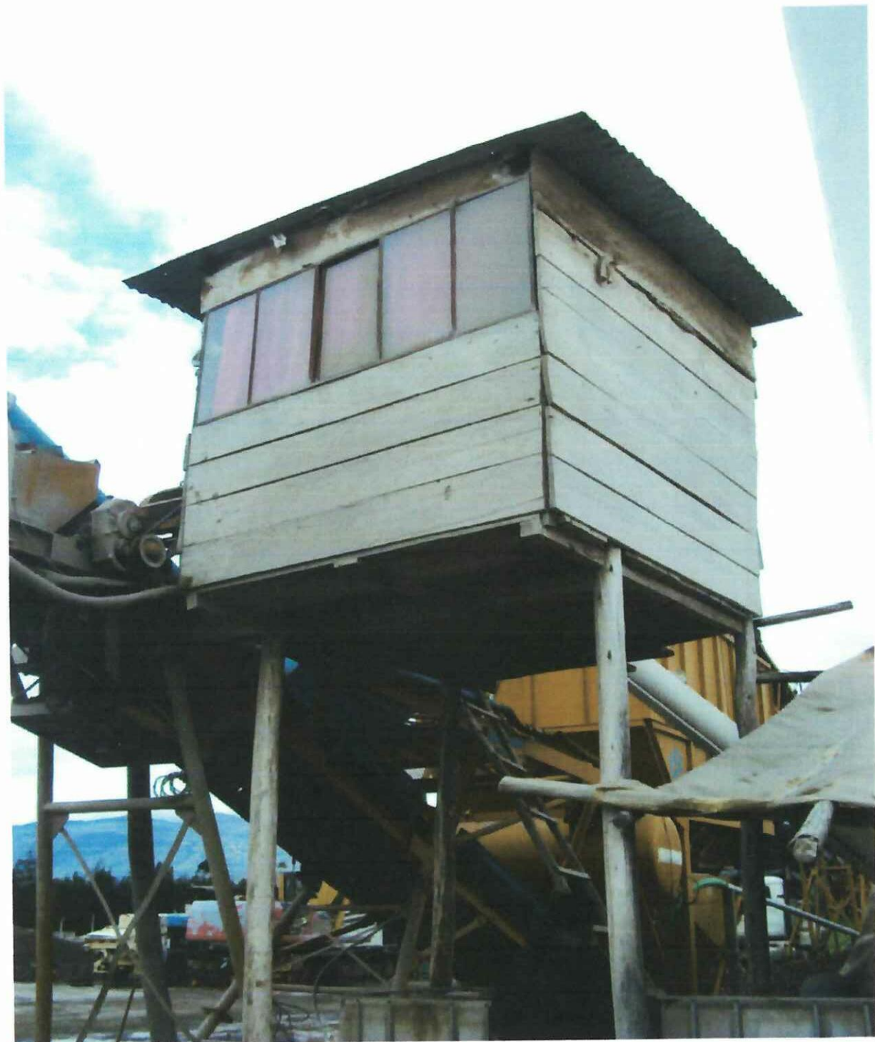
Fotografía N° 20 Torre de control para dosificar la mezcla.
