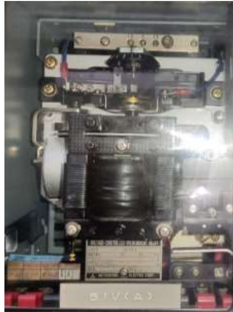
Figura N. RELÉ 51V
