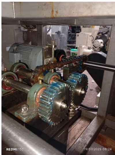
Figura A. 12 Mantenimiento de sistema mecánico y dotación de grasa en sus componentes.
