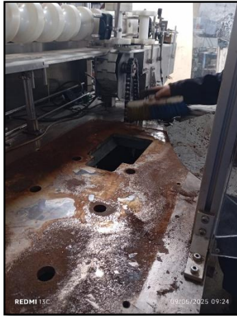
Figura 4-10. Presencia de óxido en la base del cabezal de
