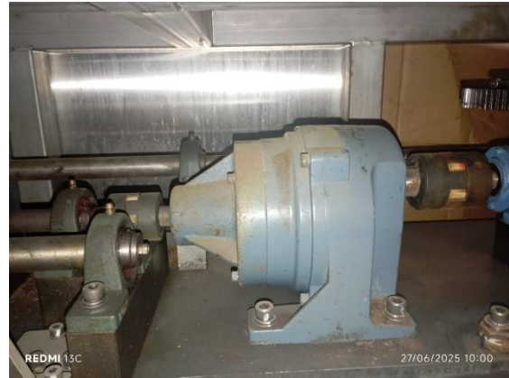
Figura A. 2 Presencia de óxido en los engranajes del sistema mecánico
