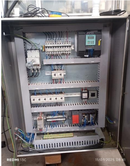
Figura A. 10 Tablero de control con los componentes eléctricos y VFD.
