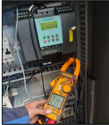
Figura 4-8. Medición de corriente de motor (2,79 A).
