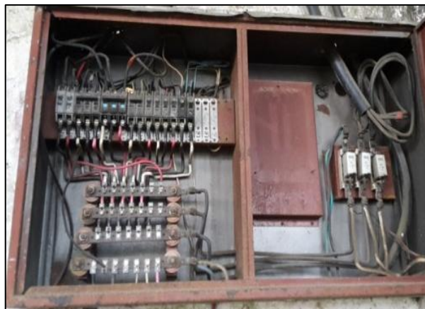
Figura 9: Tablero de distribución
