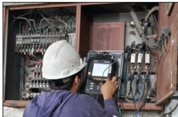
Figura 10: Instalación del analizador de redes
