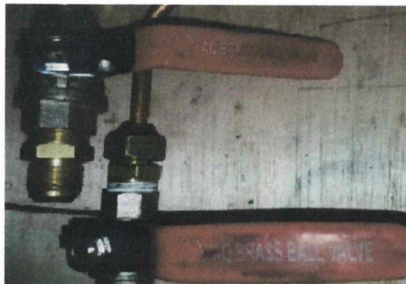
FIGURA N° 3.16. VÁLVULAS DE PASO
