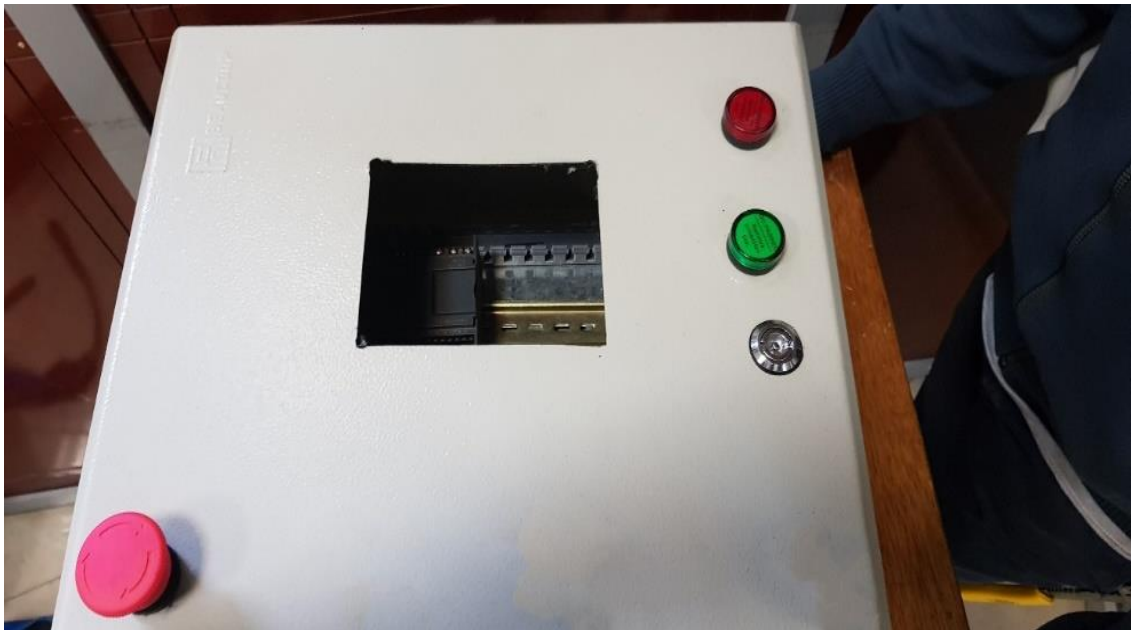
Figura VIII.1: Armado del Tablero de Control
