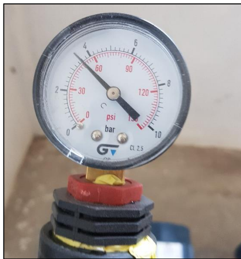
Figura 4.5: Presión en la descarga de las bombas centrífugas
