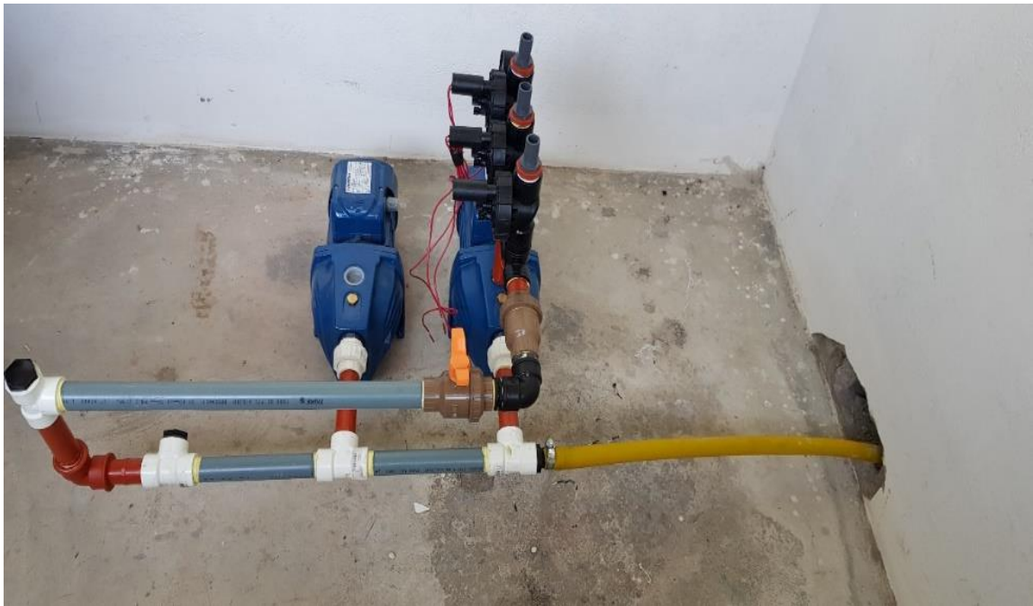
Figura VII.1: Fijación del sistema de succión y de descarga a la bomba de agua ubicada en el cuarto de control
