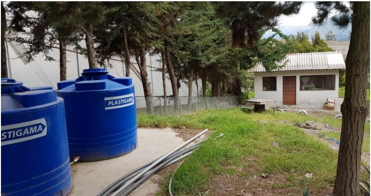
Figura IV.1: Conexión de la tubería desde los tanques hacia las bombas de agua
