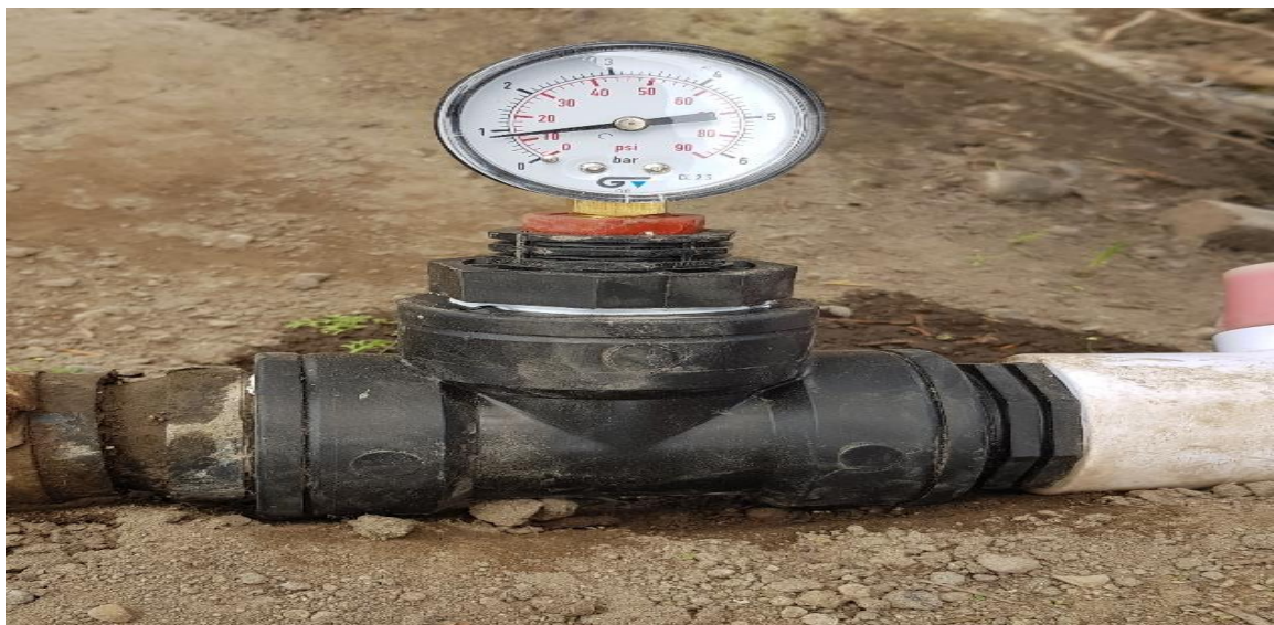
Figura VI.1: Fijación del manómetro a la entrada principal
