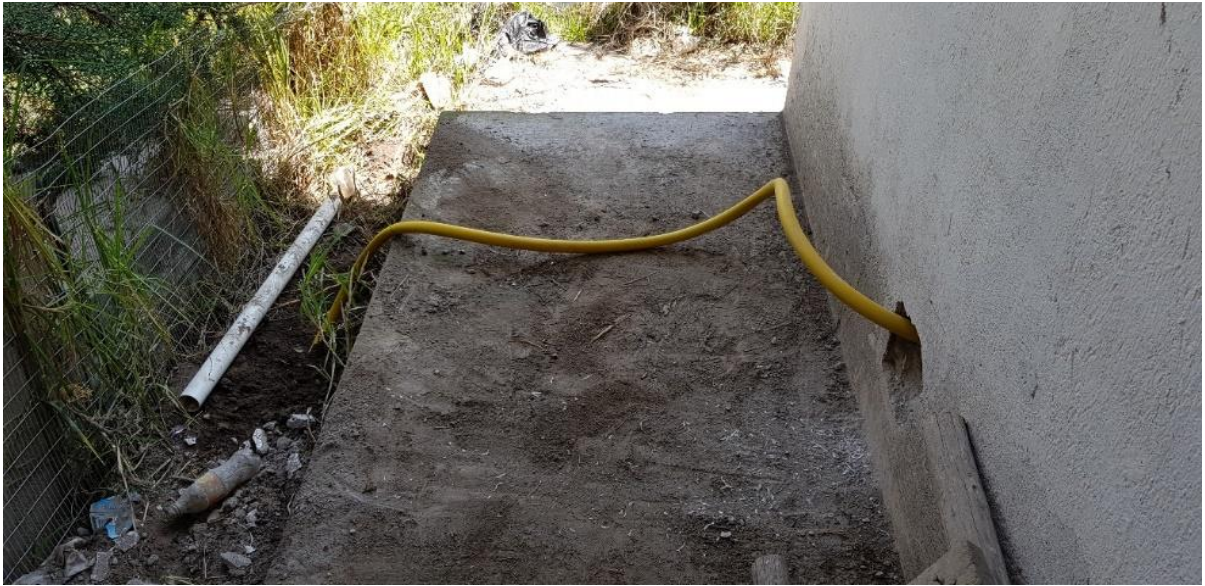
Figura III.1: Conexión de la manguera a la bomba de agua ubicada en el cuarto de control
