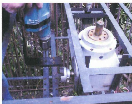
FÍGURA.N° 23: Montaje del reductor a la estructura soporte. Fuente: Realizada por el investigador
