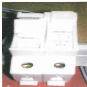
FÍGURA.Nº 39: Portafusibles. Fuente. Realizada por el investigador
