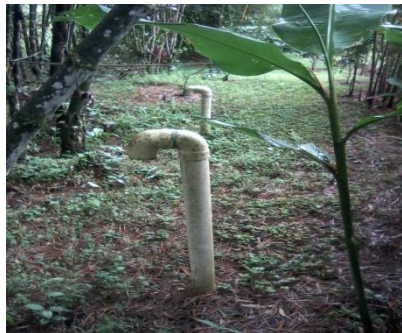
Imagen # 5 POZO SÉPTICO
