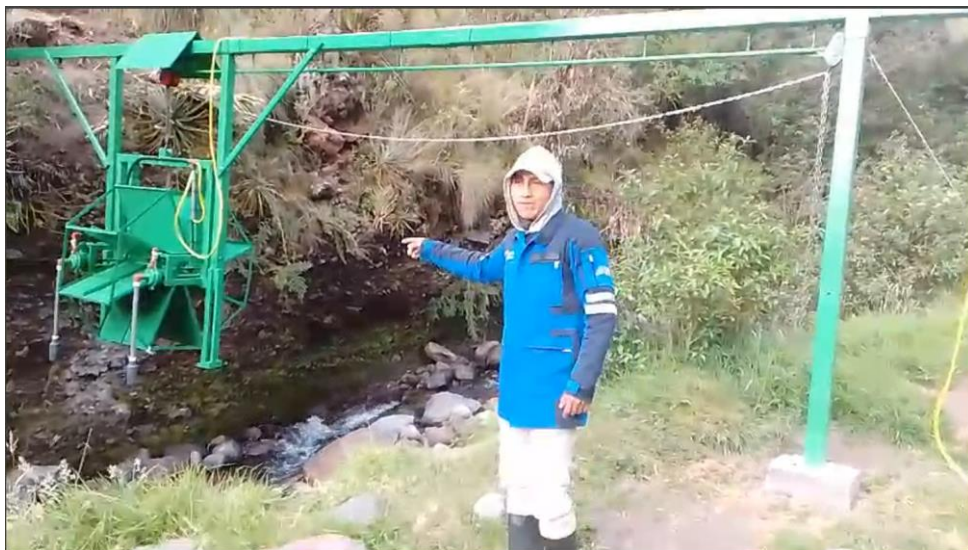
Figura 5.7. Sistema de bombeo mediante riobomba.
