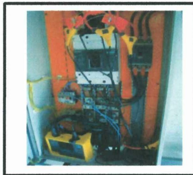
GRAFICO N° 13: INSTALACIÓN DEL FLUKE 1735
