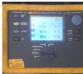
Figura 4.2. Analizador de red Fluke 1735
