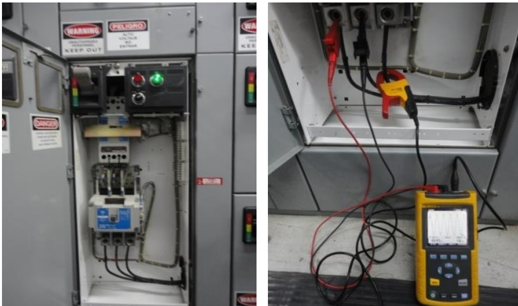
Gráfico No. 20 Arrancador eléctrico del circuito de iluminación de la estación Villano A.
