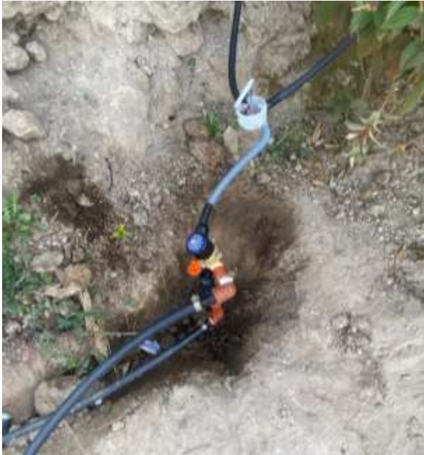
Figura 28. Implementación de la tercera electroválvula con sus respectivos sensores de presión.
