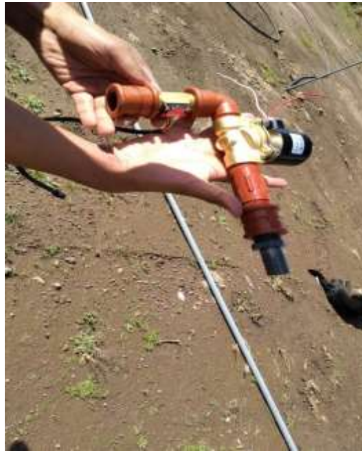
Figura 20. Diseño y colocación de electroválvulas y sensores en la tubería
