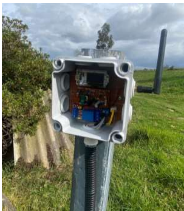
Figura 27. Instalación del 2 modulo para la comunicación LoRaWAN
