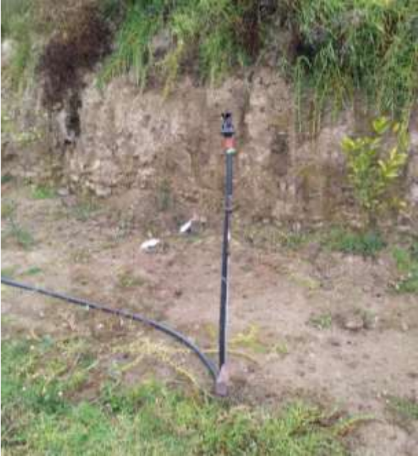
Figura 29. Aspersor instalado en la 2 planta del terreno
