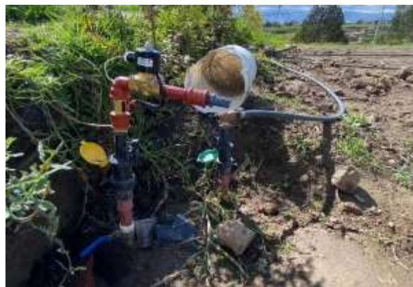
Figura 21. Implementación de electroválvulas y sensores presión
