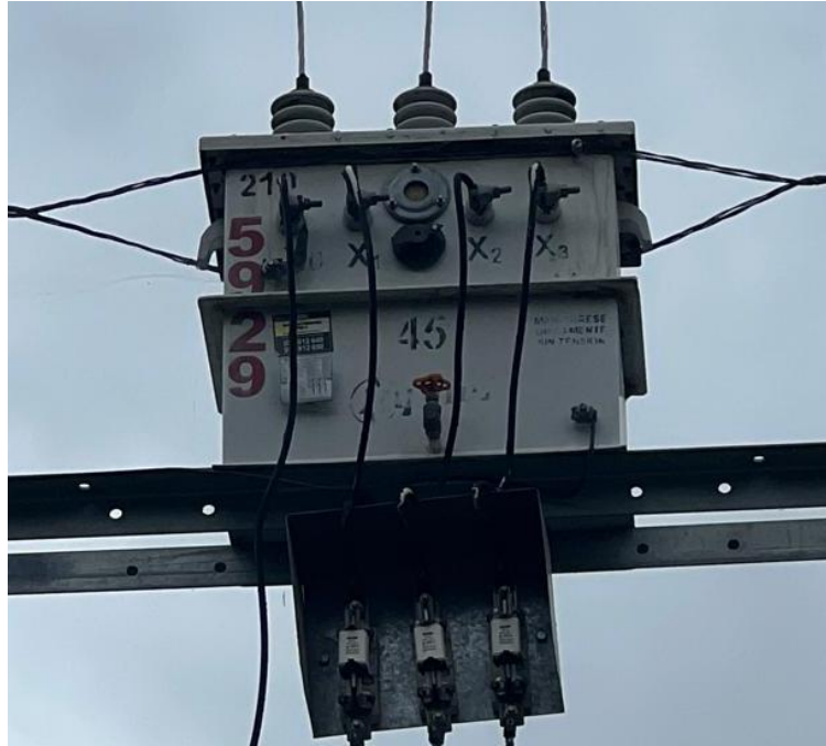
Figura 55. Transformador de 45 kVA
