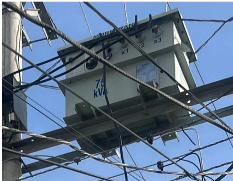
Figura 54. Transformador de 75 kVA
