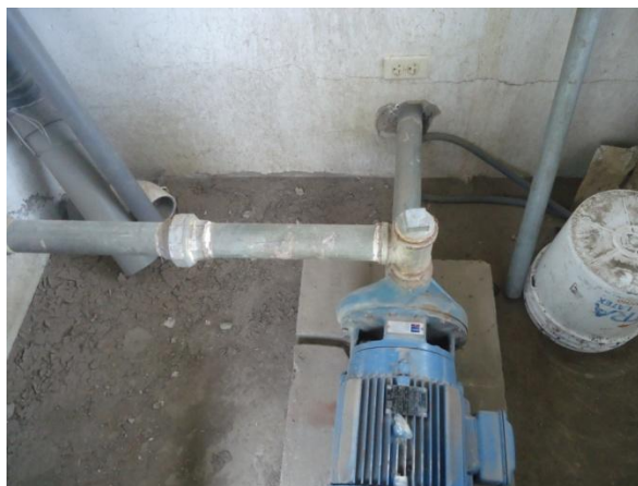
Figura 3.6 Tuberías de la bomba.
