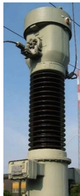
Figura 5 Transformador de corriente
