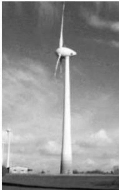
Figura 2 Aerogenerador de 4,5 MW
