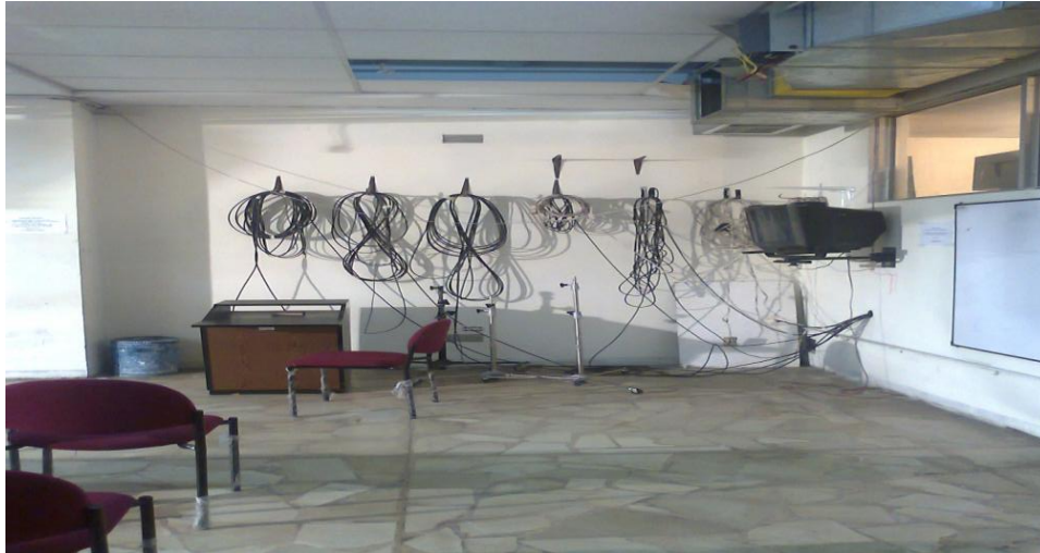
Cableado de la producción del laboratorio
