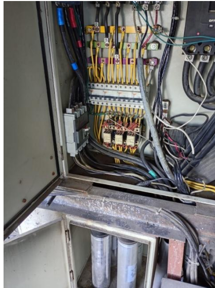
Figura 4.6 Banco de capacitores instalado en el PAC-A.
