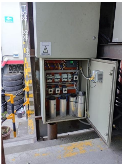
Figura 4.7 Banco de capacitores instalado en el PAC-B.
