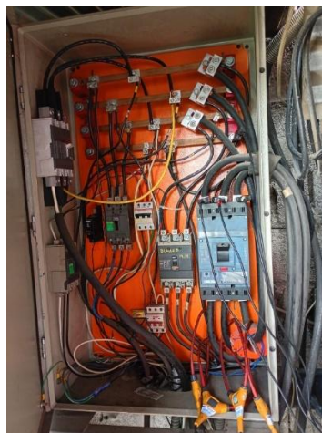
Figura 4.14 Conexión física de las pinzas de voltaje y sondas de corriente en el TP-B.
