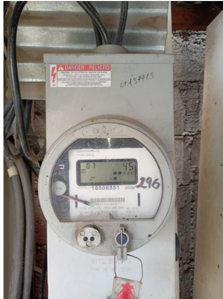
Figura 4.2 Medidor N.º 296 perteneciente al PAC-B.
