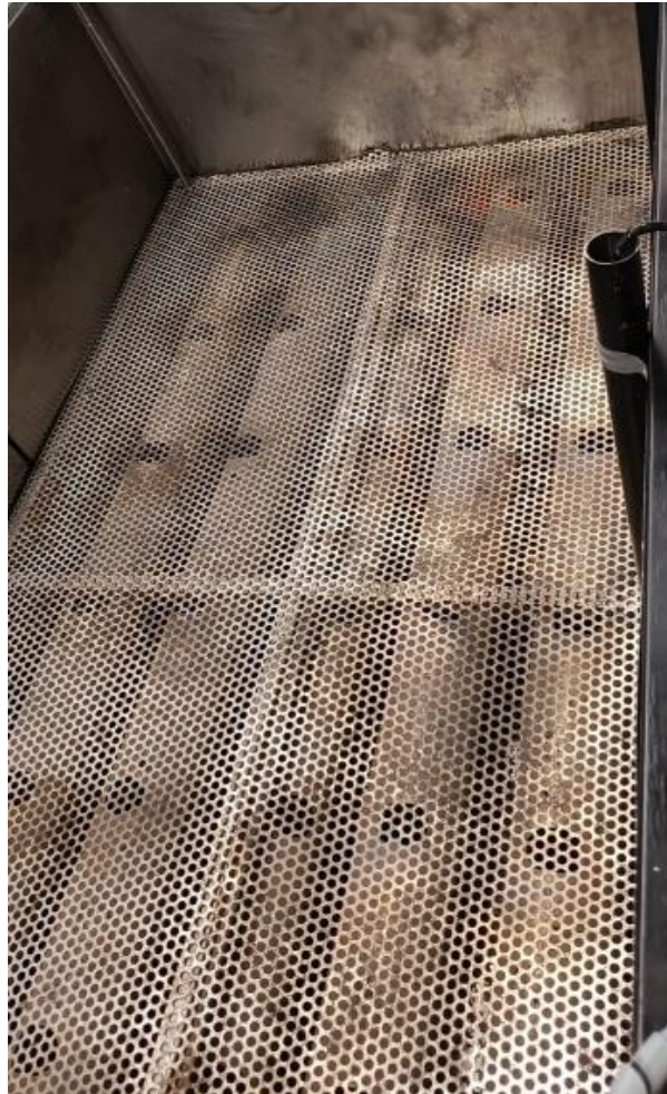
Figura 5.10. Cámara de secado con el uso del difusor.
