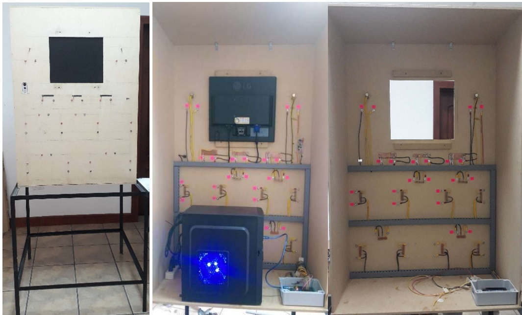
Figura I 2. Implementación del sistema eléctrico y elementos electrónicos.
