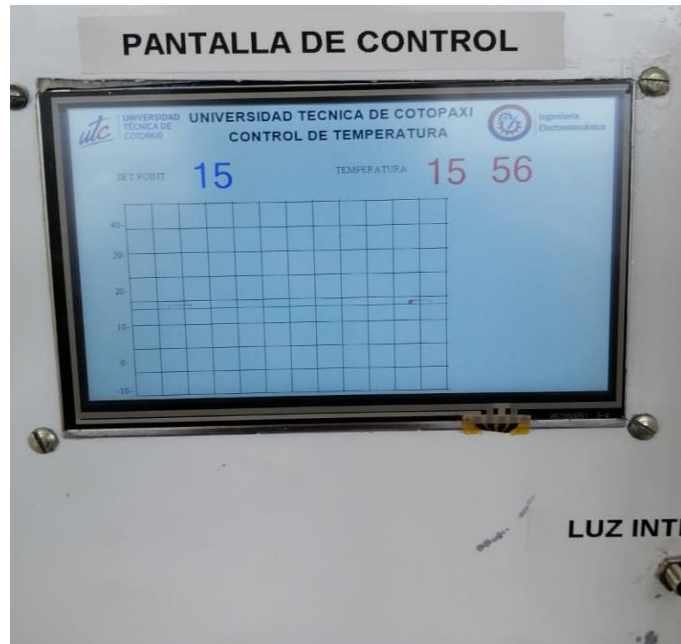
Figura 5. 12. Regulación automática de la temperatura
