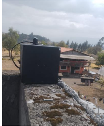
Figura 19. Instalación piranómetro Colaya Jurídico.
